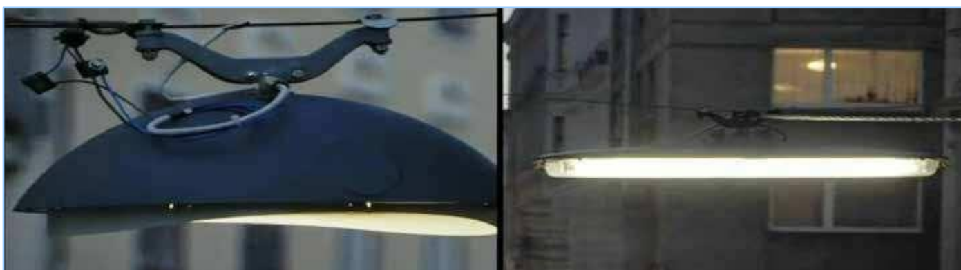
Abb. 3: Vergleich der Horizontalsicht auf die Wiener Standardleuchte (links) und eine der zuvor typischen, mit Leuchtstoffröhren ausgestattete Leuchte (rechts). Die Lichtlenkung der Standardleuchte ist erheblich präziser.
